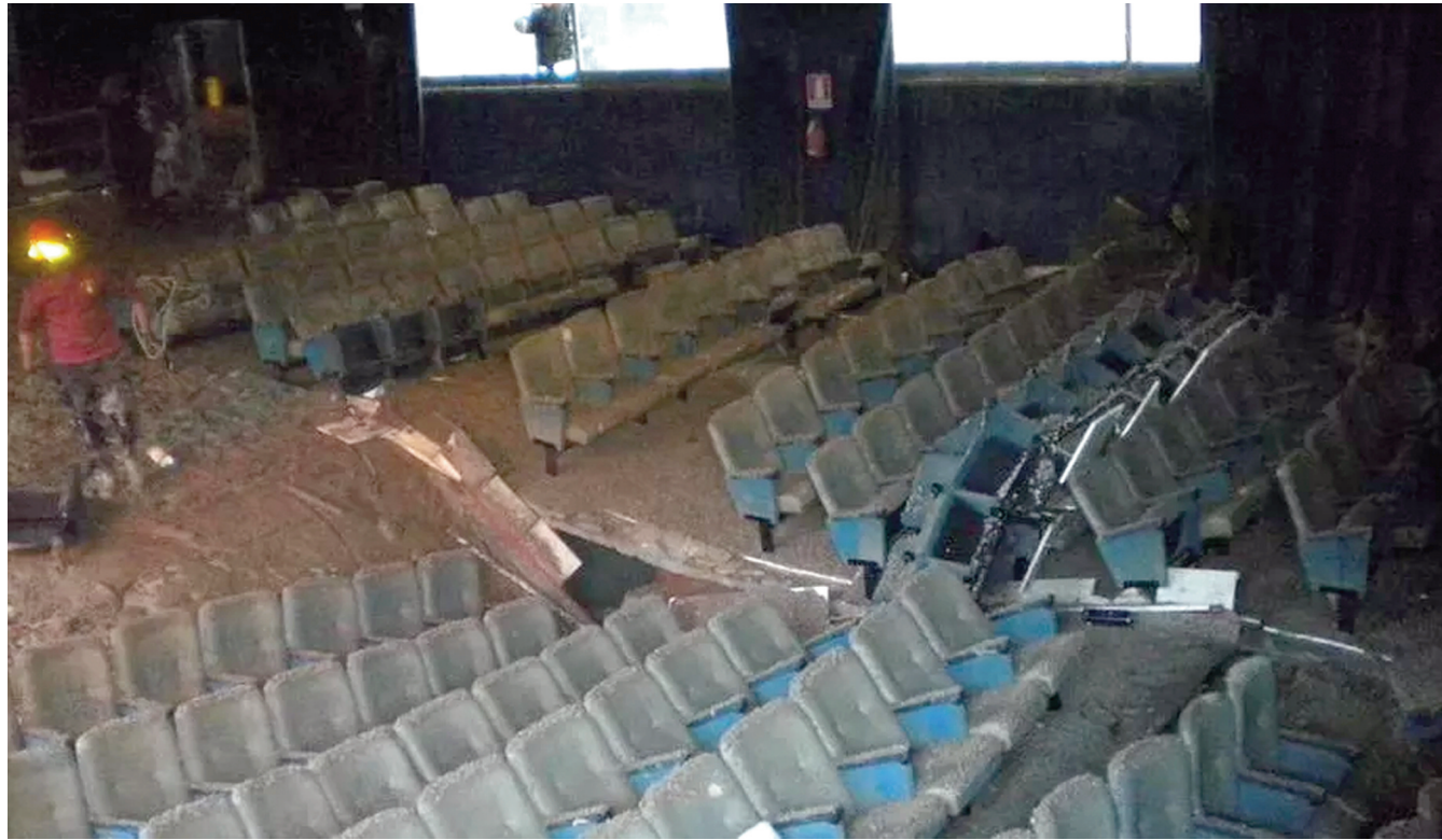
Il cinema "Città di Aulla" dopo l'alluvione del 25 ottobre 2011. Il recupero della sala è tra gli interventi programmati
